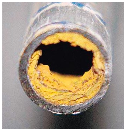
Rohrinfarkt durch Fettablagerung. Der sachkundige Betrieb eines Abscheiders gewährleistet, dass es so weit nicht kommt
